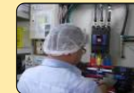
風機電力量測
